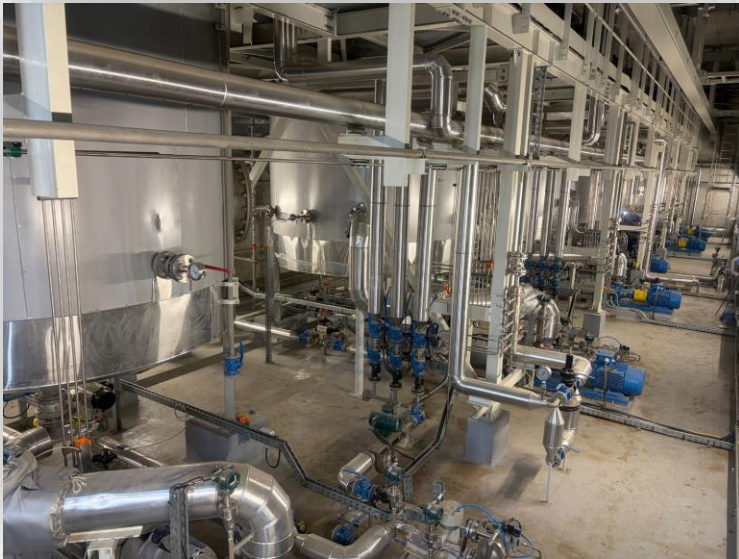
Rezervoari tečnog otpada
