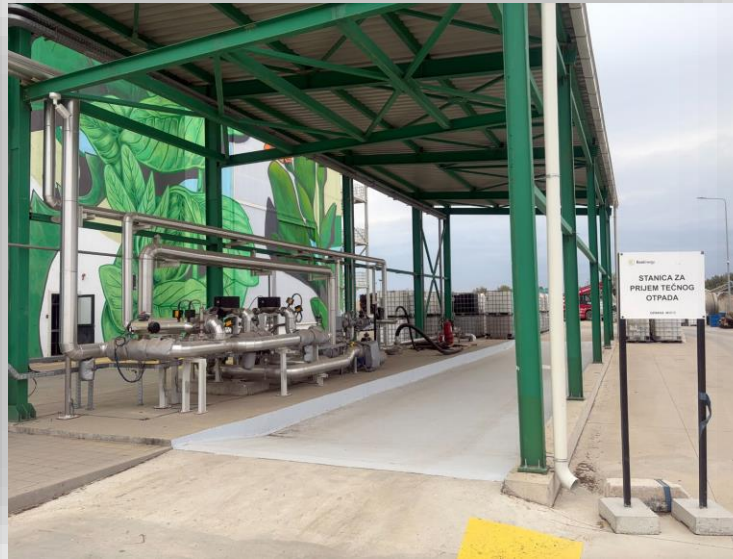
Stanica za pretakanje
